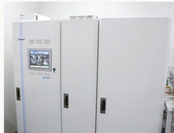
▲写真2 逆浸透法精製水製造装置
